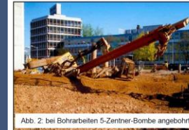
Abb. 2: bei Bohrarbeiten 5-Zentner-Bombe angetroffen
